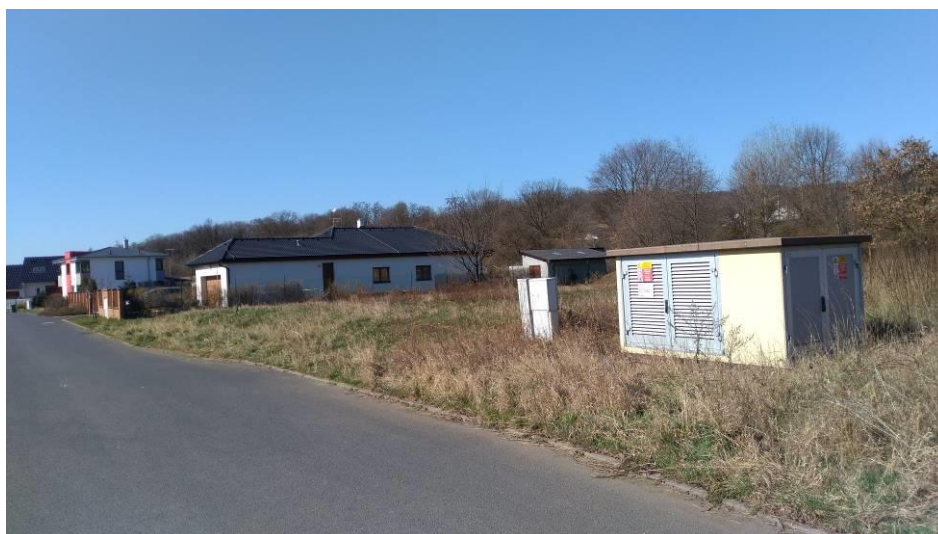
Stávající trafostanice na okraji řešené lokality
